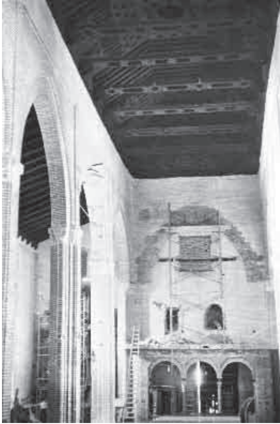
Lám. nº 10.- Construcción de la nueva tribuna para el órgano a los pies de la nave central, siguiendo las directrices del plano de la lámina nº 9.
