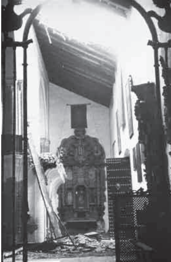
Lám. nº 7.- Hundimiento parcial de la cubierta de la Nave del Evangelio en 1963.
