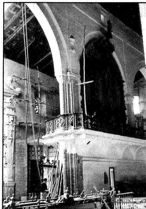
Trabajos de desmantelamiento del coro, observando el órgano aún en su antigua ubicación.
